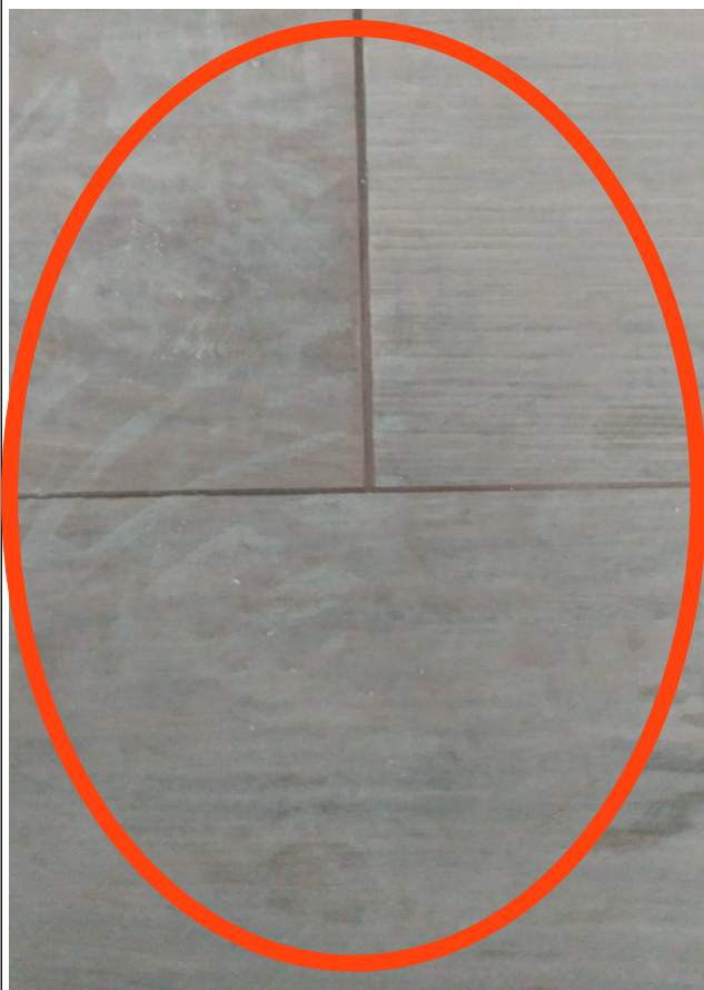
Imagem 03 – revestimento piso – rejuntamento.
