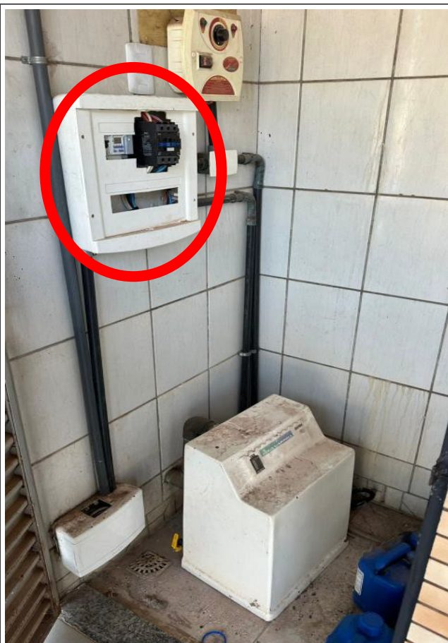
Imagem 02 – local Quadro de Disjuntor Proteção sauna.
