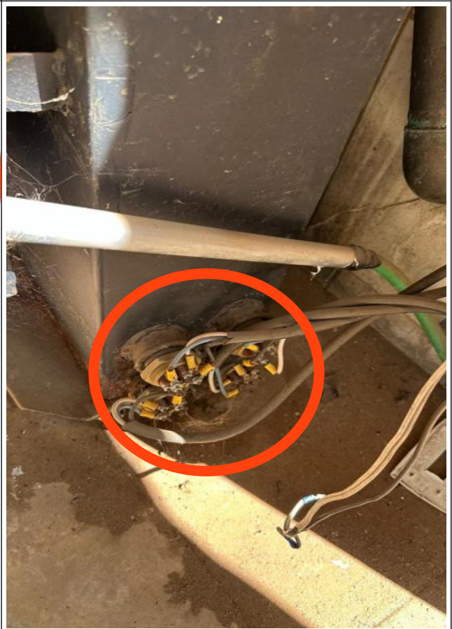
Imagem 04 – terminais de ligação resistência.
