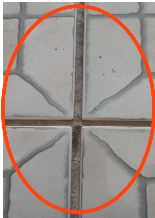
Imagem 03 – revestimento piso – rejuntamento.
