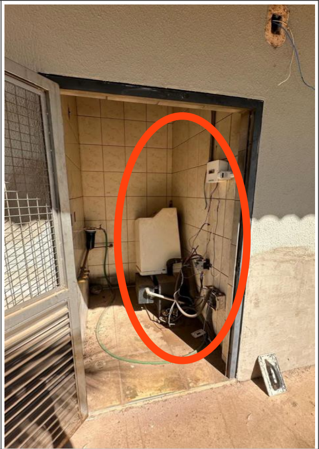
Imagem 02 – Quadro de disjuntor proteção sauna
