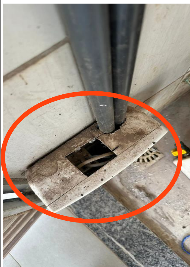
Imagem 03 – Caixa de passagem – alimentação Resistência.
