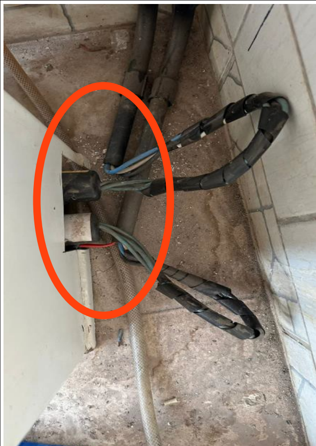
Imagem 04 – terminais de ligação resistência.
